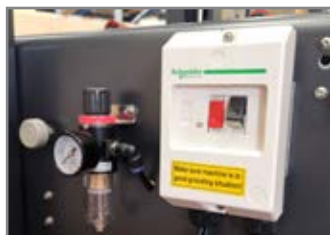
INTERRUTTORE GENERALE MAIN POWER SWITCH
